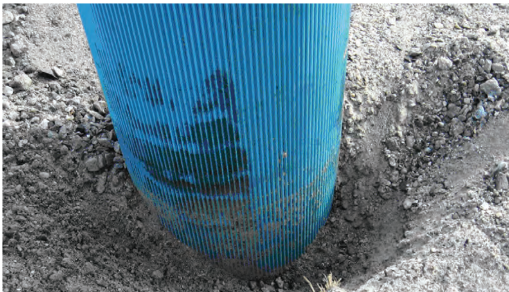
Fig. 27. Pozo sin cementar
