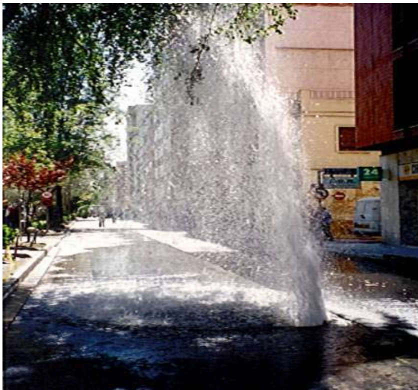
Fig. 4 Avería en una tubería
