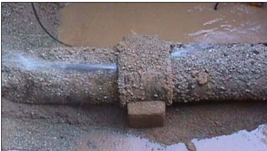
Fig. 7 Avería en una junta entre tubos
