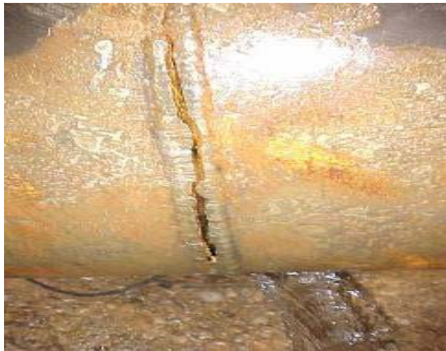
Fig. 69 Rotura de una soldadura circular.
