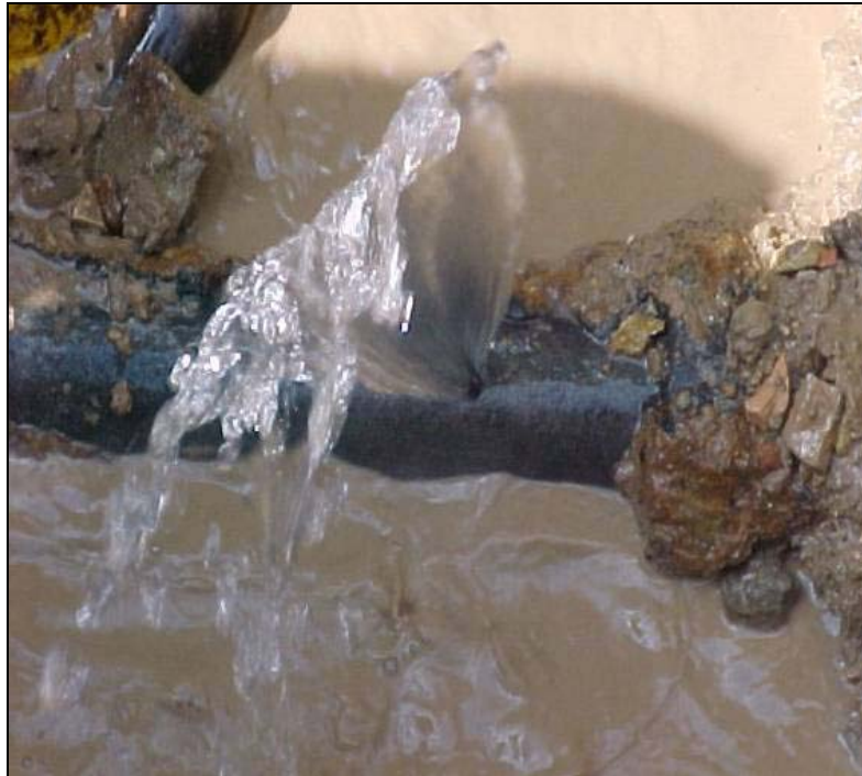
Fig. 6 Avería en una tubería
