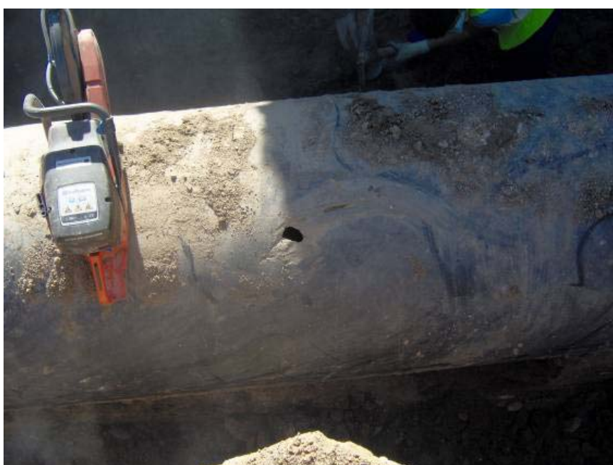
Fig. 30 Picotazo en tubería de fundición dúctil.
