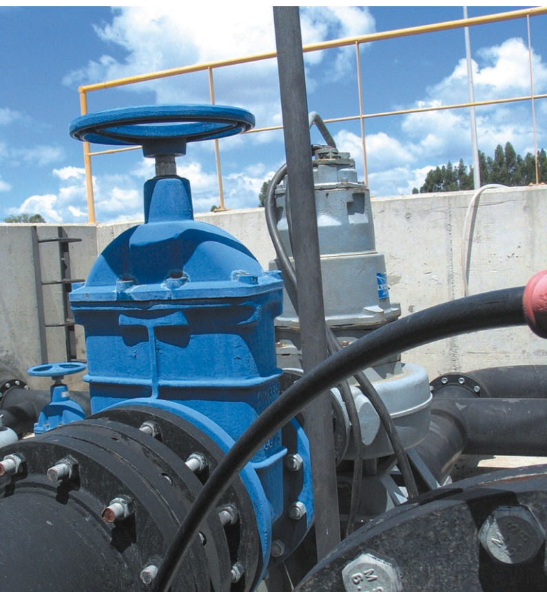
Planta Depuración Minas
